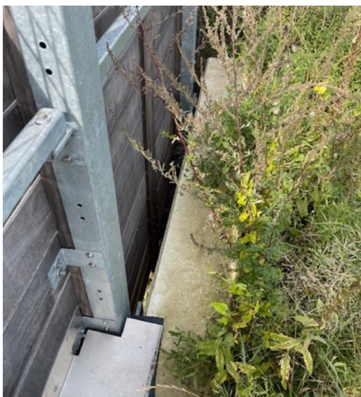
Figuur 21: Ontbrekende panelen op het ecoduct.
