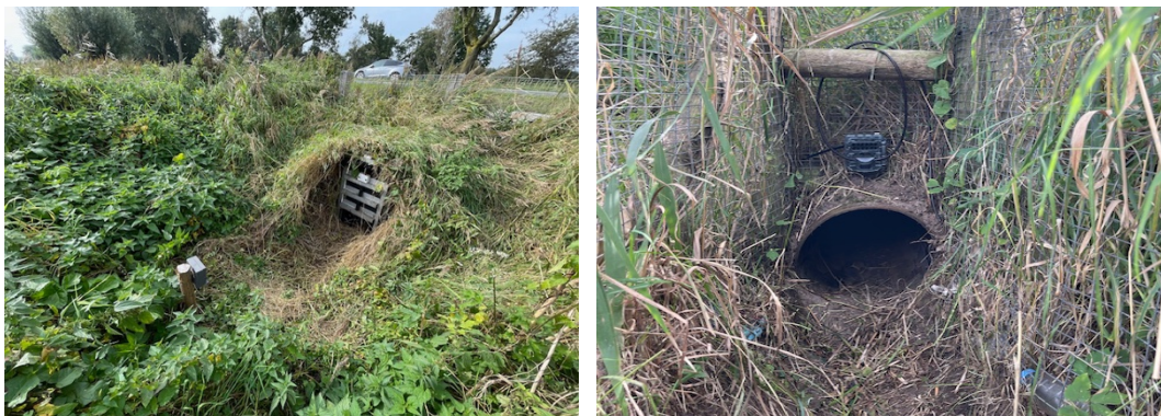
Figuur 12: De camera opstelling bij de N375. Links nummer 19 en rechts nummer 20.
